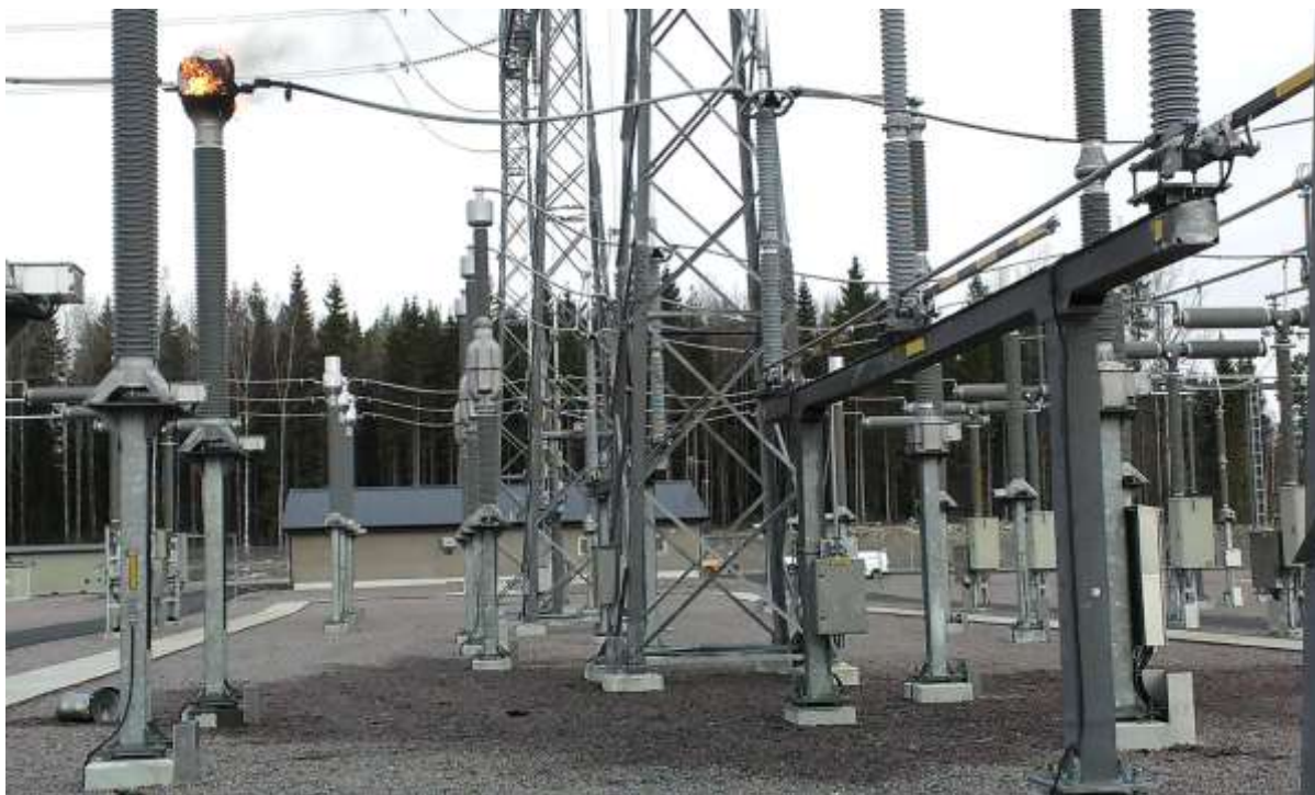
Figur 8. Bild från ett haveri på en strömtransformator. Det mörka partiet på gruset visar hur oljan spridit sig. Det rör sig uppskattningsvis om cirka 100-150 liter olja på cirka 60-70 kvadratmeter.
