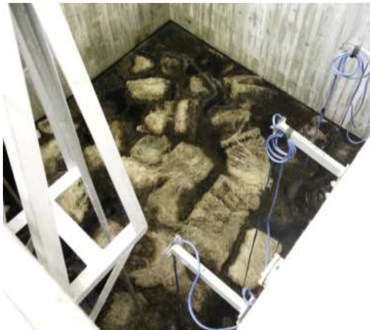
Figur 6. Filtterummet i oljeavskiljningsanläggningen. Balarna av hyvlat träull, som utgör filtret, ska egentligen ligga fastspända och tätt intill varandra. Balarna ligger i tre lager, det är oklart hur de undre lagren är placerade.
