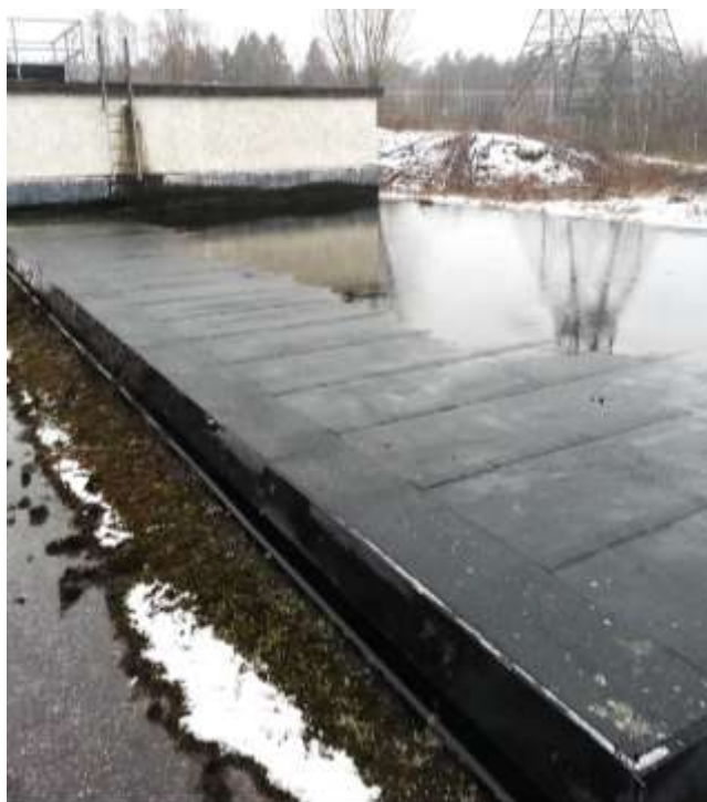
Figur 7. Oljeavskiljningsanläggningen ligger under jord. Takets inbuktning är mer än vad som är tillåtet för en sådan typ av konstruktion. På bilden ovan har regnvatten samlats på taket.
