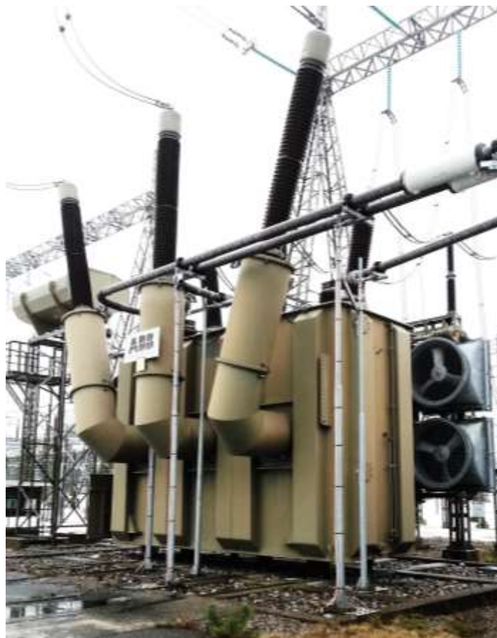
Figur 2. En trefasig krafttransformator.
